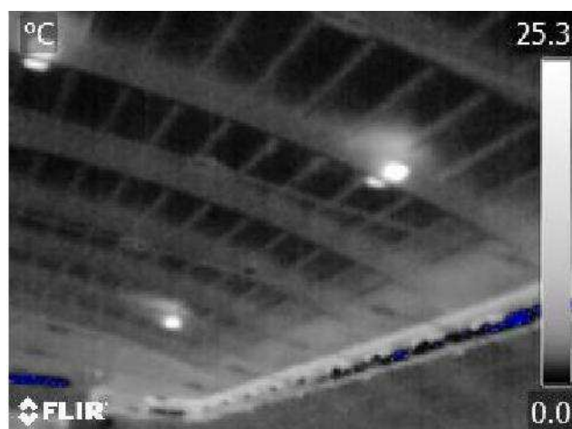
Rys.11. Termogram powierzchni dachu badanej hali lodowiska po wprowadzeniu alarmu punktu rosy
